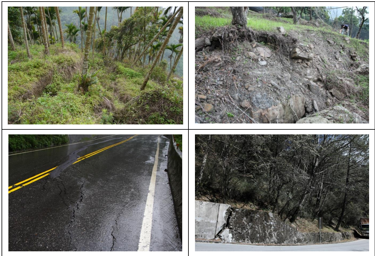
圖 5-3 常見的地表變形現象，係潛在山崩與地滑之徵兆。左上：小崩崖與樹木傾倒；右上：崩崖；左下：張力裂縫發育漸造成道路陷落；右下：擋土牆破壞外推。
